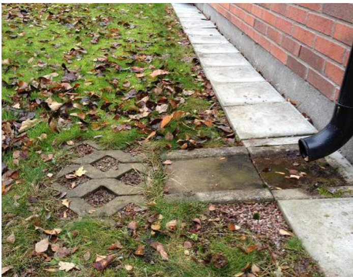
Figur 11 Utkastare som leder ut vatten till gräsmattan.
