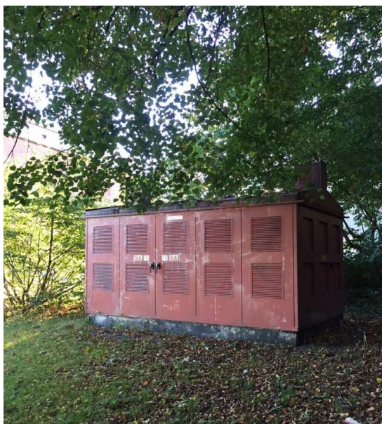
Transformatorstationen inom planområdet.
