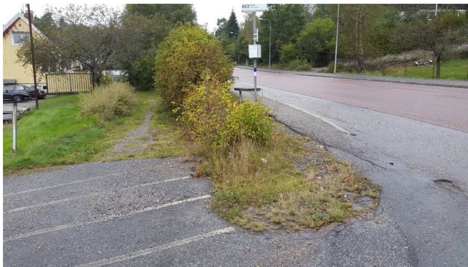
Figur 19. Dike saknas mellan väg 274 och befintlig bebyggelse. Vägområdet är mycket ottydligt, men har tolkats in vid släntfot. Vy ifrån öster.
