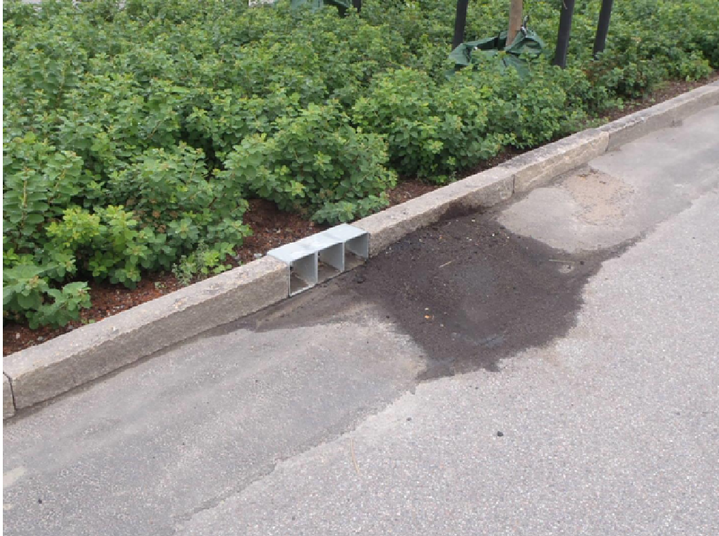
Figur 6. Exempel på försök med enklare lösning där vattnet leds direkt in i en öppen växtbädd med buskar och träd. Foto Björn Embrén Trafikkontoret.
