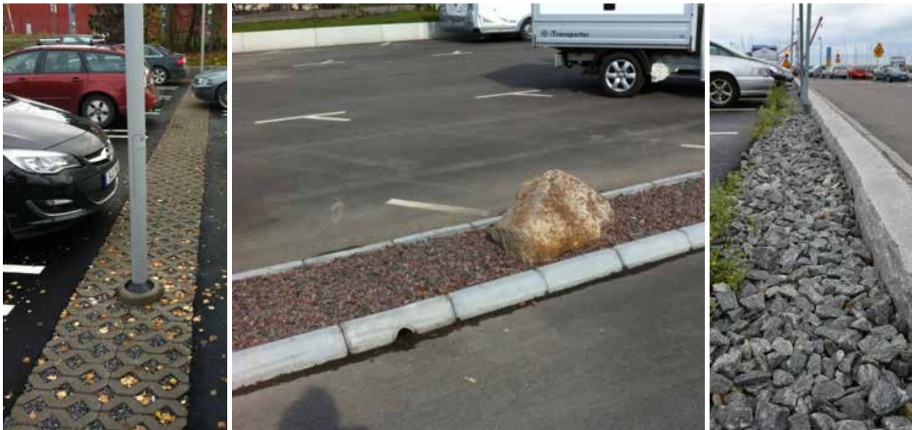
Tre exempel på utformning av makadamdiken. Till vänster en körbar yta med betonghålsten (med makadamdike under), i mitten inlopp till diket genom en kantsten med hål och till höger en ej körbar överyta.
