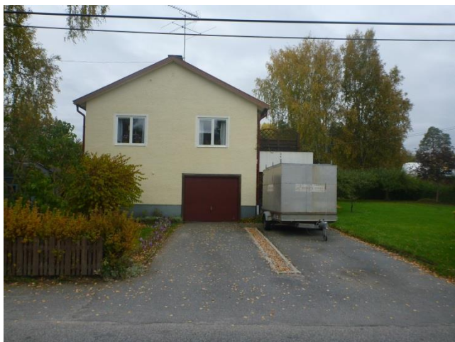
Bild 1. Hus vid Klockvägen. Stuprör går ned i marken. Fastigheten har enligt ledningskarta idag ingen anslutning till dagvattenanläggningen.
