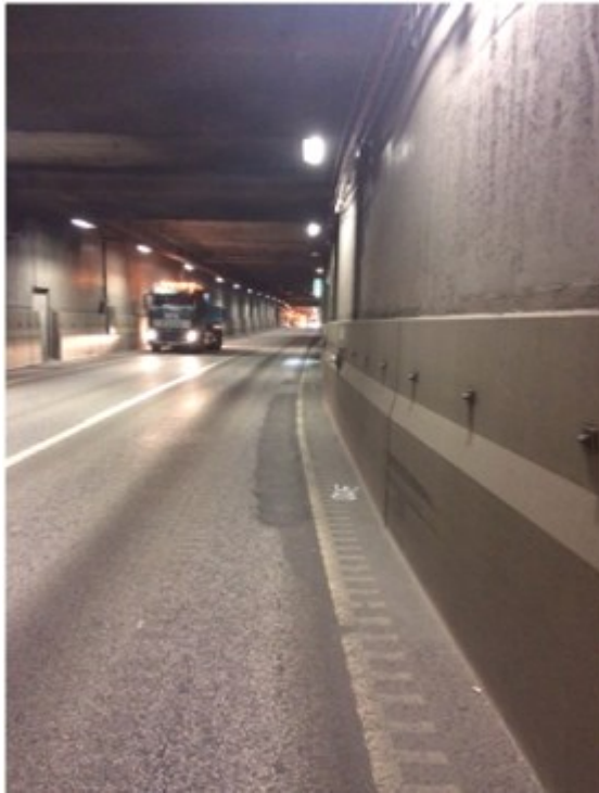
Söderledstunneln innan åtgärd
