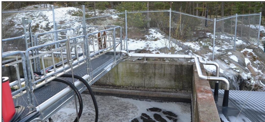
Figur 1 SBR-reaktorn på Telegrafholmens avloppsreningsverk
