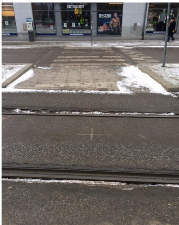
Skador i beläggning intill räl, Hammarbysjöstad
