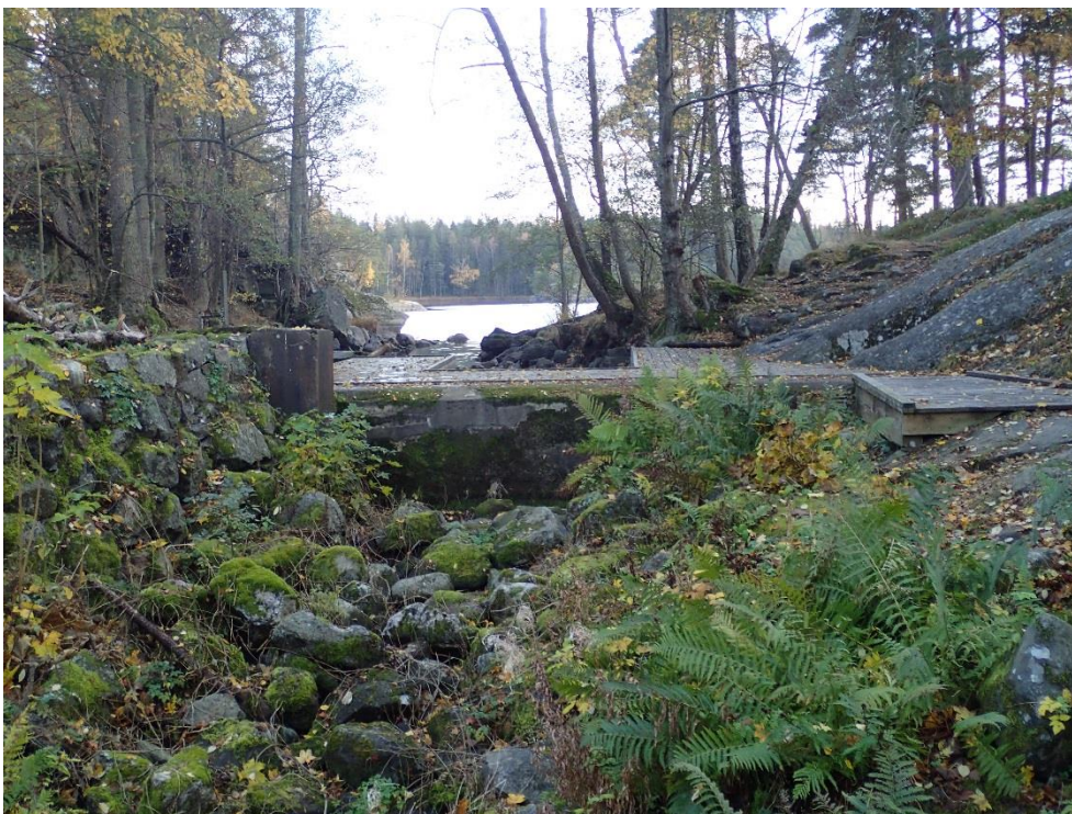
Figur 28. Till vänster om Kvarndammen finns en anslutningsdamm i betong som är i dåligt skick. Vattnen tränger fram under konstruktionen. Ovan dammen i bild finns en upptagningsplats för kanoter. Norconsult 2016.
