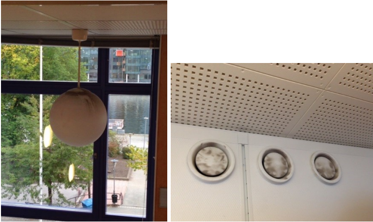
Figur 4 & 5. Exempel från tillsynen - Bristfällig städning.
