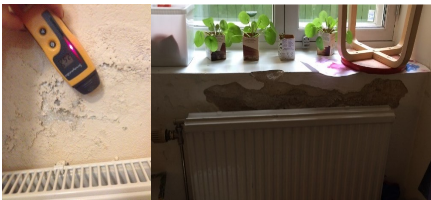
Figur 2 & 3. Exempel från tillsynen - Misstänka fuktskador i en skola (fig. 2) och i en förskola (fig. 3)
