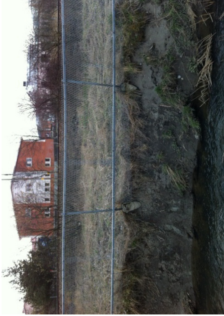
Figur 19. Genom erosion har Bällstaån vandrat allt närmare den befintliga banvallen.
