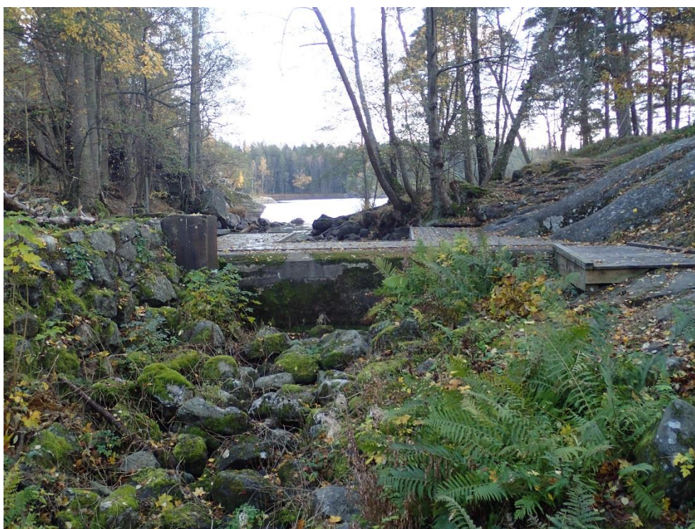
Figur 28. Till vänster om Kvarndammen finns en anslutningsdamm i betong som är i dåligt skick. Vattnen tränger fram under konstruktionen. Ovan dammen i bild finns en upptagningsplats för kanoter. Norconsult 2016.
