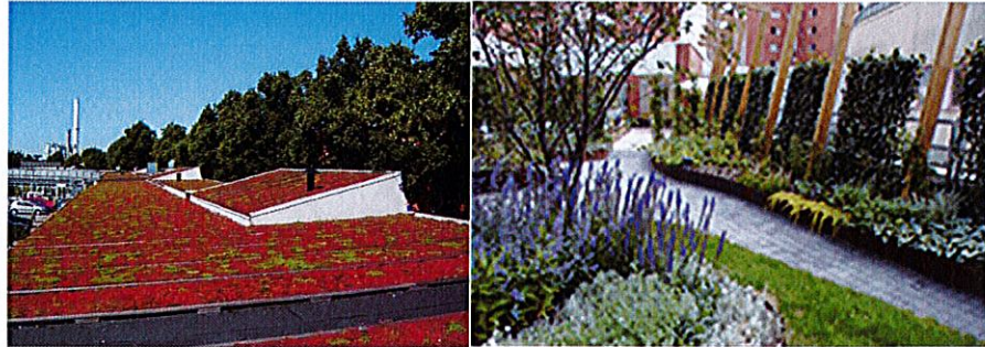
Figur 5. Gröna tak med olika karaktär och fördröjningsförmåga
