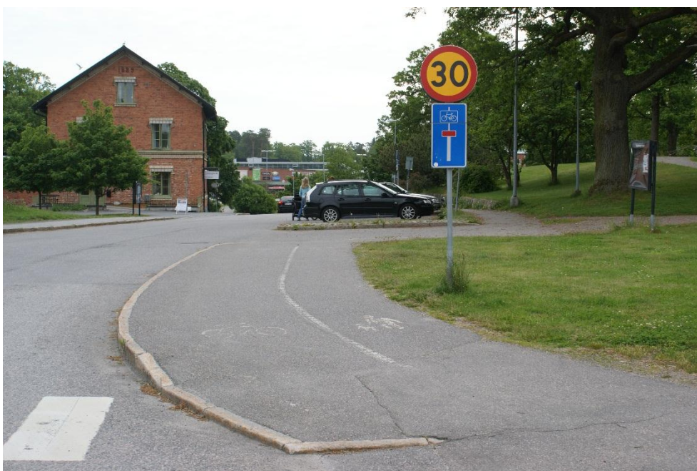
Slutet på det regionala cykelstråket Nacka-Värmdö vid Gustavsbergs kyrka. Otydlig mittlinje och slitna cykelmyror. Det ligger även kantsten i cykelstråket. Med små åtgärder kan säkerheten öka
