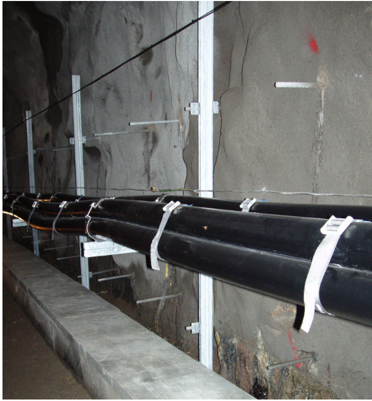
Figur 5.2. Foto av motsvarande kabelförband i en tunnel.
