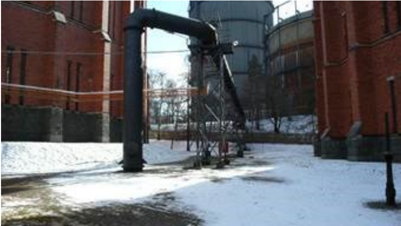
Bild 1 – gasledningens sträckning mellan gasklockorna och över Gasverksvägen
