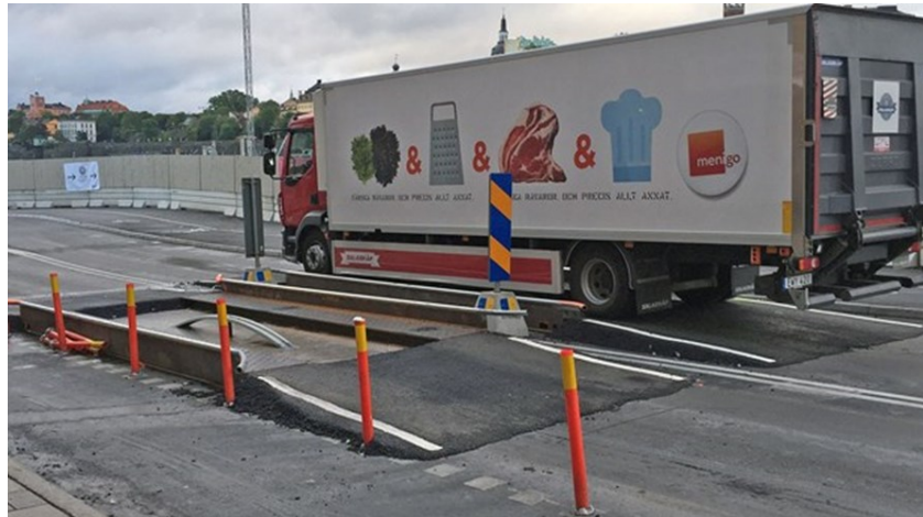
Figur 5 Spårviddshinder med ramp, exempel från Slussen
