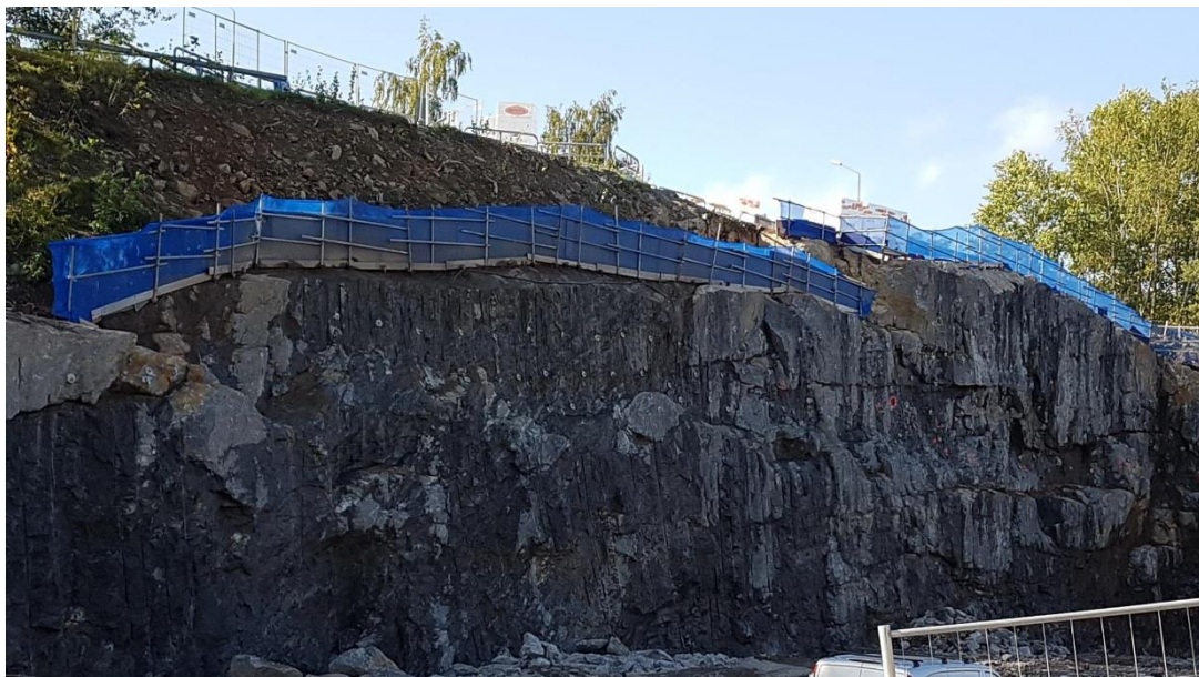
Figur 7. Fotografi tagit mot väster av en hållskärning mot Bollmoravägen-Granängsvägen, som visar några subhorisontella bankningsplan.
