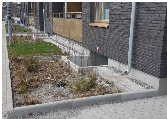
Figur 17 Takvatten till större växtbädd med kupolsil som avleder dagvatten vid högre flöden.
