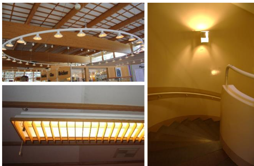
I IBM:s anläggning finns många specialritade armaturer av Bengt Lindroos och Nyréns. Ovan t.v: Takarmatur i matsal. Nedanför: lysrörsarmaturer med fururaster. T.h.: Huvudtrapphusen. Genomarbetad färgsättning och blanka ytskikt samt specialritade armaturer. Bild Tyréns.
