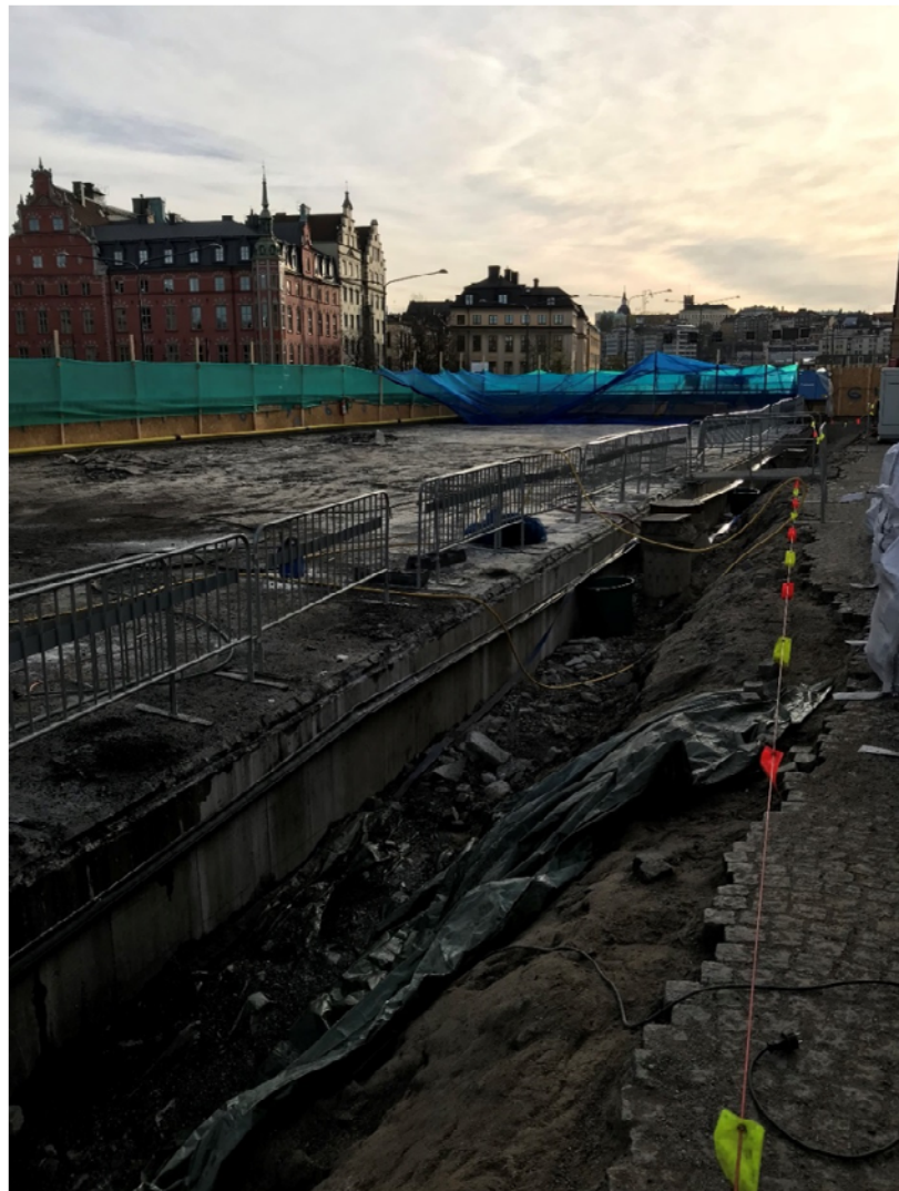
Figur 4. Blottlagt tunneltak på Riddarholmen. Foto Miljöförvaltningen, Stefan Troëng
