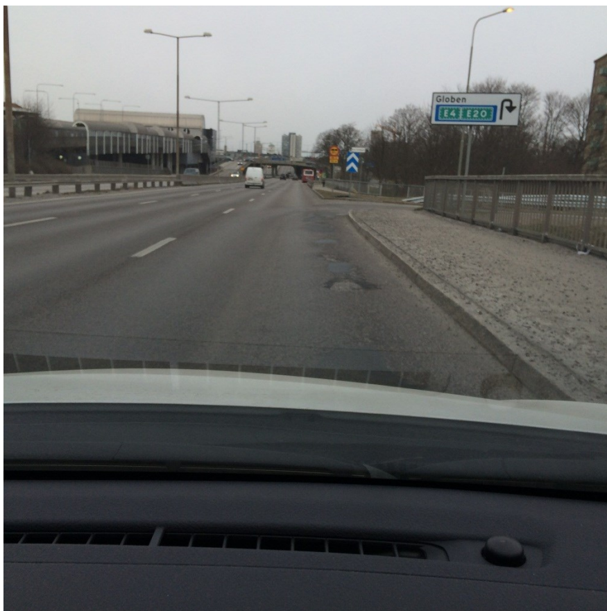
Exempel på sliten beläggning med ”potthålslagning”.
