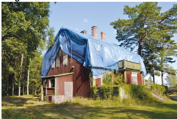
Figur 21 Susegårda, Byggnaden har stått utan underhåll under lång tid
