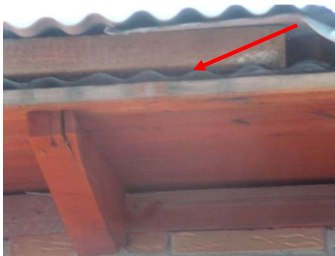
Det gamla sinuskorrugerade plåttaket ligger kvar under det senare påbyggda plåttaket av samma typ.
