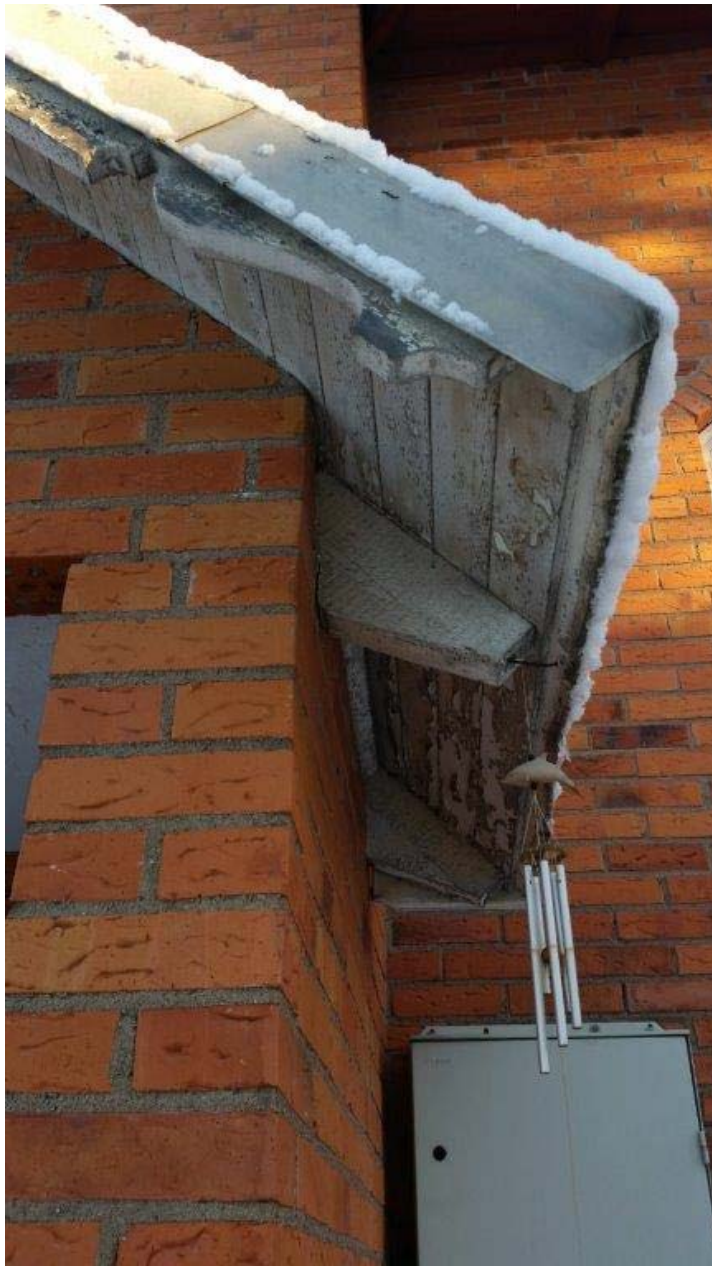
Takfot. Exempel på bristande underhåll.
