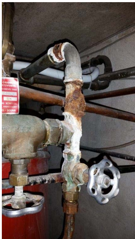
Bild 20. Rör, rörventiler och el-ledningar i pannrum.
