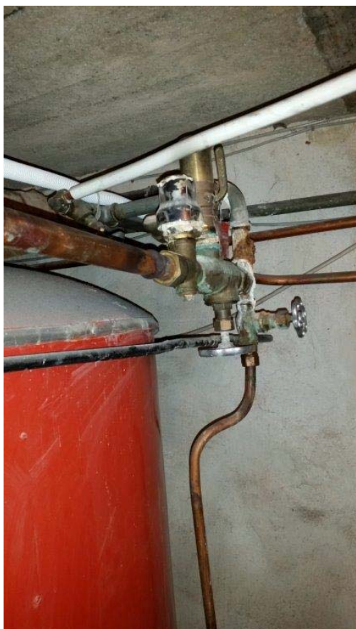
Bild 17. Rödrdragningar vid överkant värmepanna.
