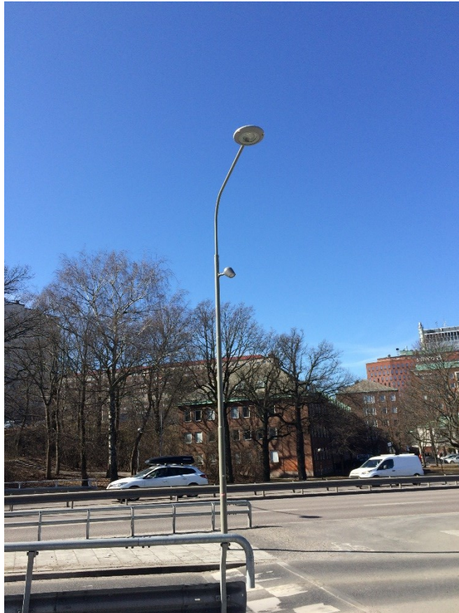
Figur 12. Förbättrad belysning på hela sträckan och extra armaturer vid övergångställena.
