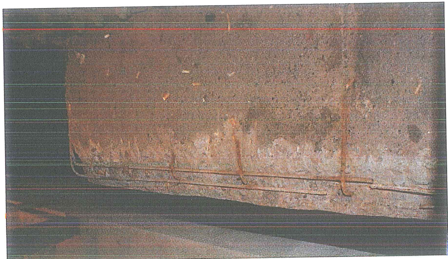
Rostande armering som spjälkat bort omgivande betong
