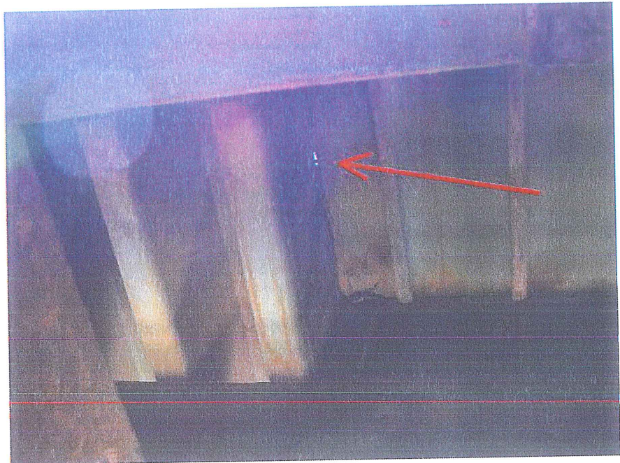
Kassetter, rost och spricka vid pilspetsen
