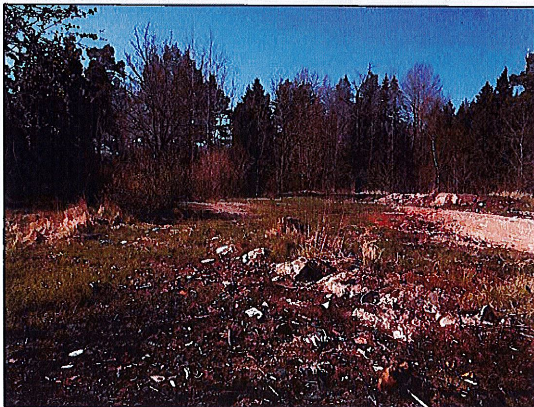
Figur 2-1. Höjden i planområdets södra del. Byggnaderna som tidigare legat på platsen hade vid tiden för platsbesöket rivits.
