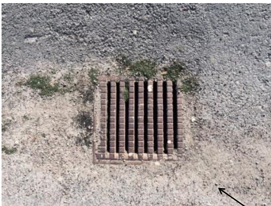
Bild 2. Dagvattenbrunn på Stadshagens IP. De små svarta prickarna är granulat och det gröna är plastgräs. Foto: Jenny Fäldt.
