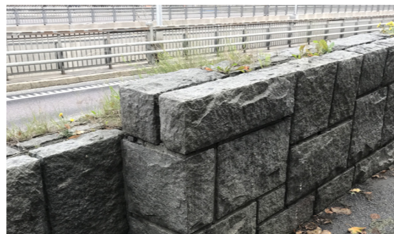
Referensbild på rubbelmur vid den nya parkeringsplatsen som knyter an till befintlig gestaltning.
