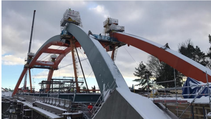
Bild 4 Montage av mittsektionen av bågen. Den nya bron förtillverkades i relativt små sektioner som sammanfogades till större enheter vid sidan av vägen och som därefter lanserades ut över järnvägen med den tillfälliga skyddsportalen som stöd.
