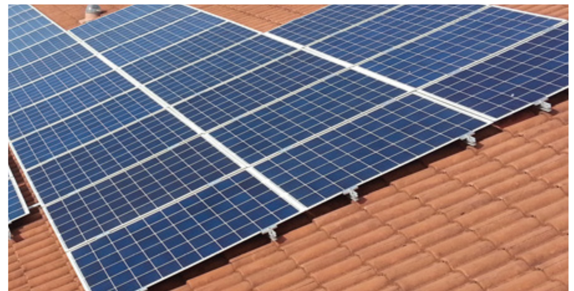
Solpaneler på tegeltak
