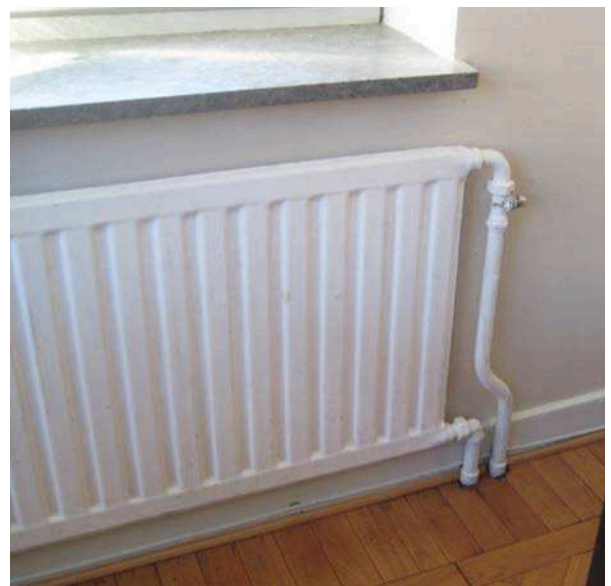
Äldre vattenradiator i tillbyggnadsdelen. Stora rördimensioner som är anpassade för självtryckssystem.
