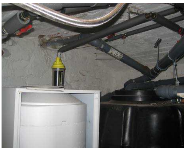
Installationer i huvudbyggnadens källarutrymme. Bl.a. tank till fettavskiljare.
