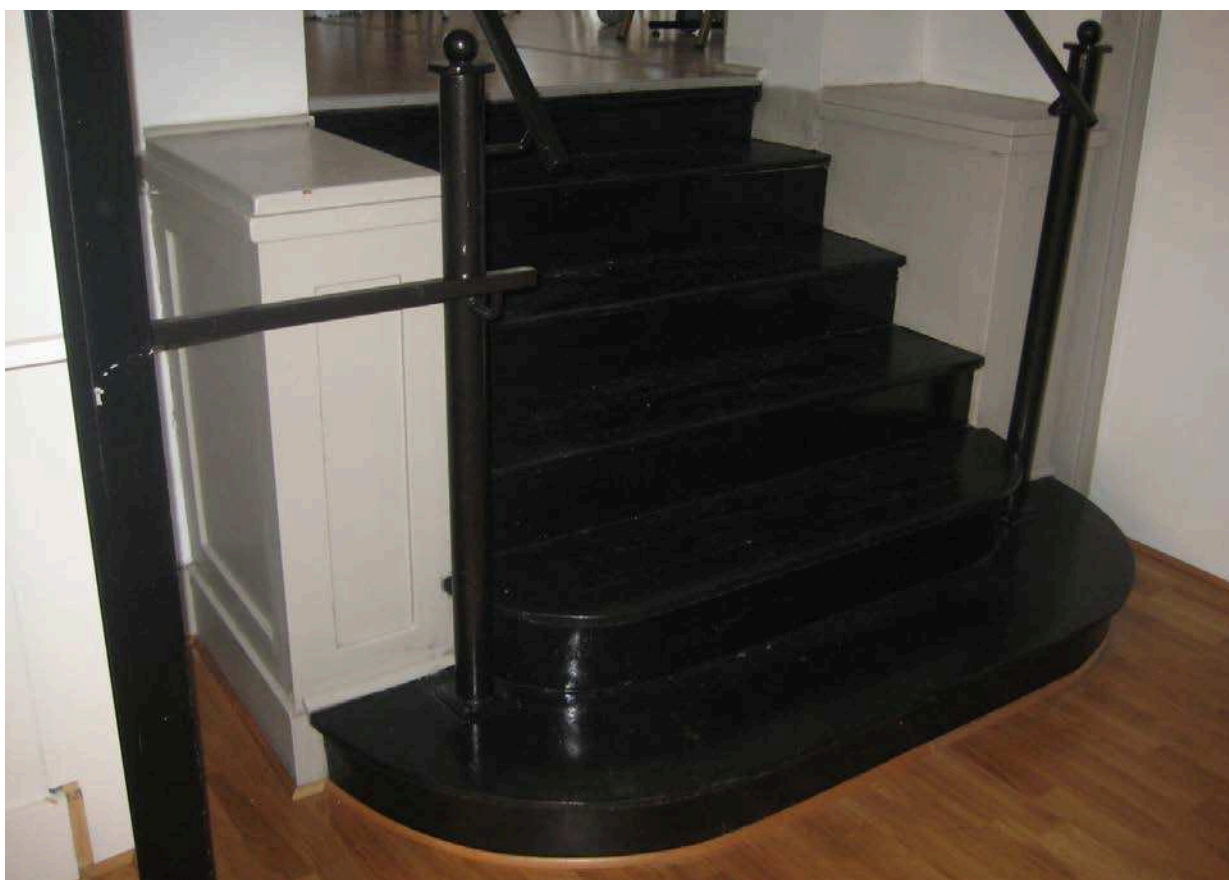
Invändig trappförbindelse i tillbyggnadsdelen som gör att restauranglokalerna på övervåningen inte är tillgängliga för rörelsehindrade.
