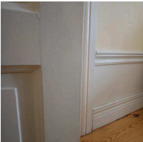
Detaljbild av äldre dörrblad och sentida snickerier i ett av de två mest välbevarade rummen på våning 1 tr.
