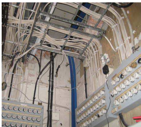
El-centraler i huvudbyggnadens bottenvåning. Omfattande dragningar av kablage där sannolikt delar tagna ur bruk eller provisoriskt anslutna i samband med tidigare genomförda rivningar.
