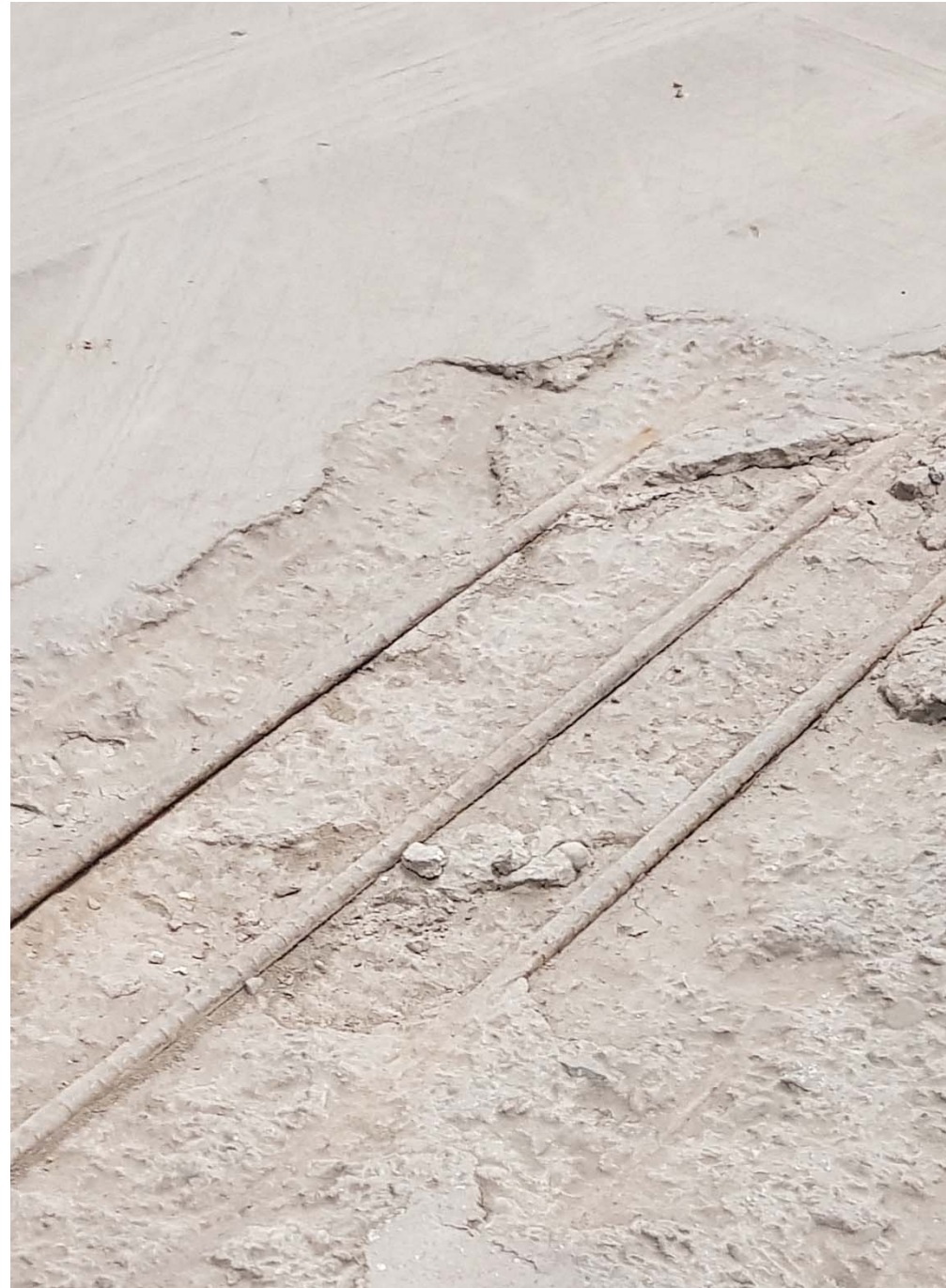
SKADA I BETONGBJÄLKLÄG
