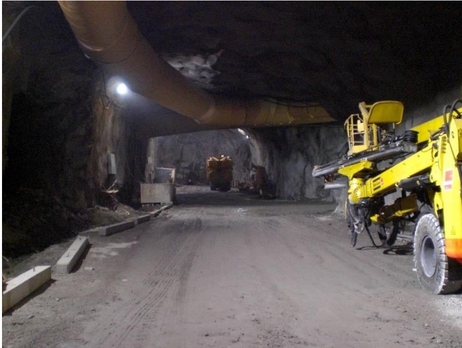
Figur 4 En arbetstunnel med en tilluftskanal (Foto: RISE).
