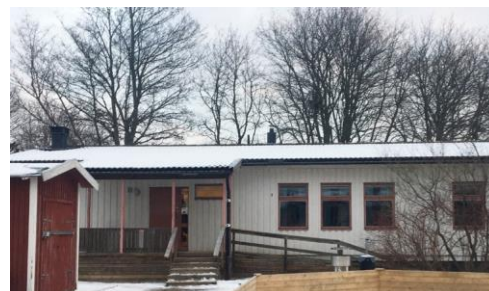
Hus G. Byggnad som skall rivas på grund av mycket dåligt skick.
