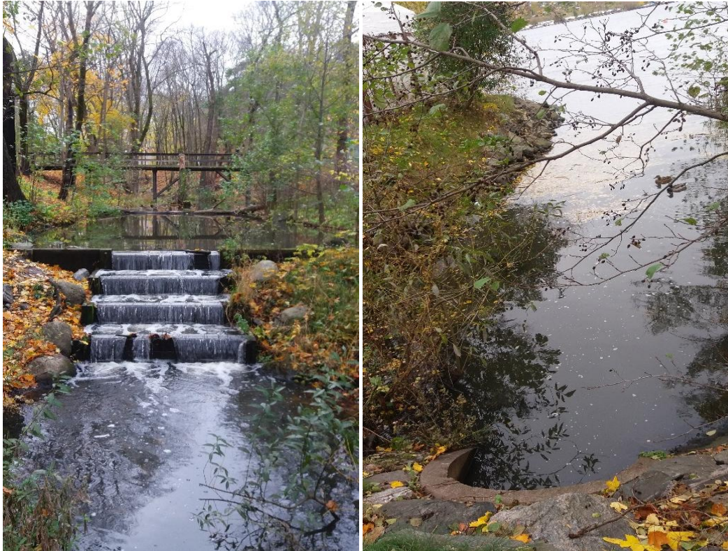
Figur 8. Den västra av de två bäckarna i anslutning till Årstaviken. Till vänster i bilden visas fisktrappan samt bron över bäcken. Till höger i bilden visas kulverten under vägen nedströms fisktrappan.
