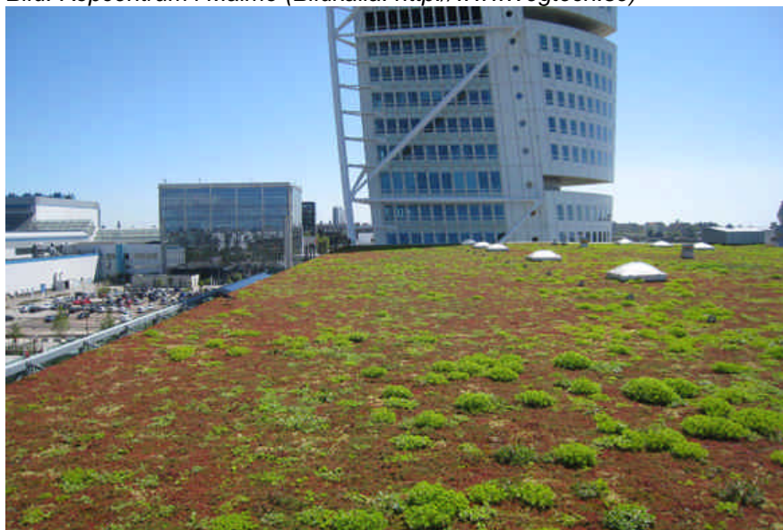
Bild: Garagetak i Västra Hamnen, Malmö (Bildkälla: http://www.vegtech.se )
