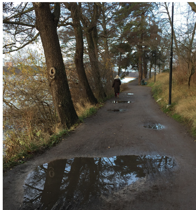
Vattenpölar på gång- och cykelväg
