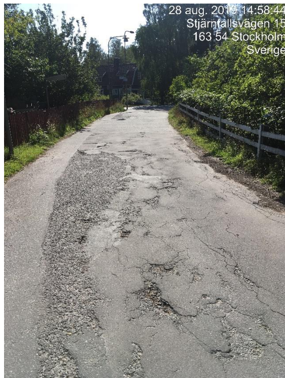
Figur 8. Potthål, sprickbildning och spårbildning
