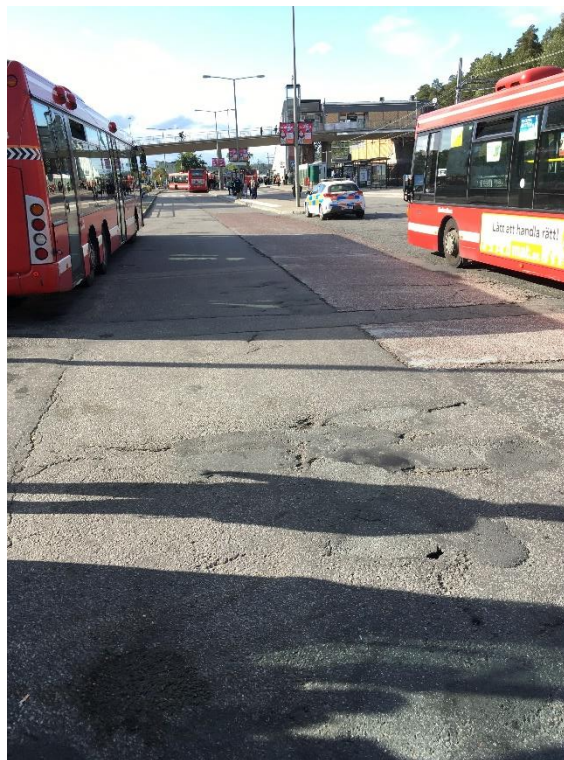
Figur 3. Potthål och gamla lagningar
