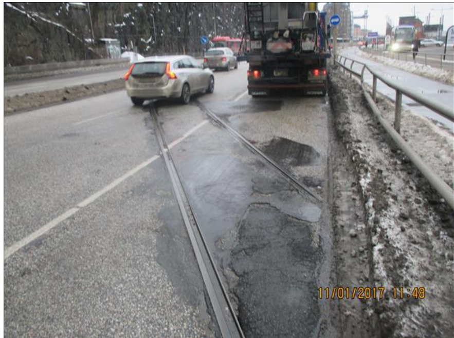
Bild 3 Temporära lagningar och spårbildning vid Stadsgårdsleden.
