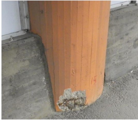
Figur 5. Exempel på skada på bärande pelare vid rampen mot Sveavägen
