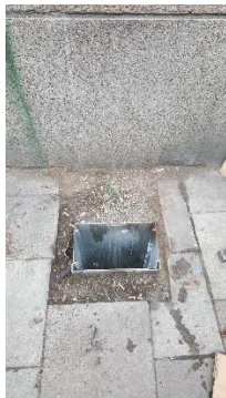
Bild 2: Det befintliga stativet har kapats i marknivå.
