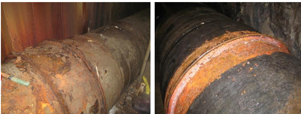
Bild 1 och 2, Större korrosion vid områden med takdropp, samt korrosion som bildats vid rörskarvar. Bilder från utredning utförd 2012.
