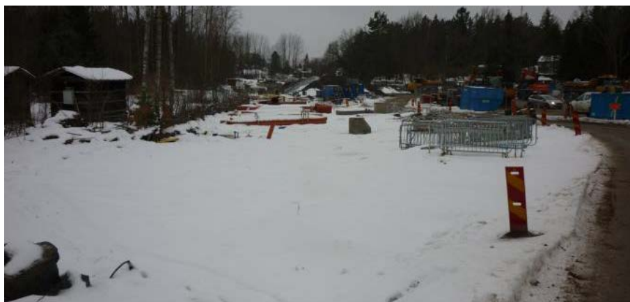
Figur 12. Etableringsområdet för den pågående VA-utbyggnaden i Högmora, en plats som i framtiden ska kunna hysa en skola eller förskola. Foto från WRS och Naturvatten (2017), se referenser.
