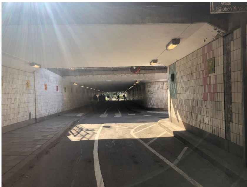
Bild 2) En bredare gångbana och en smal refug i östra delen av tunneln. En ramp som delar tunneln i mitten syns till höger i bild.
