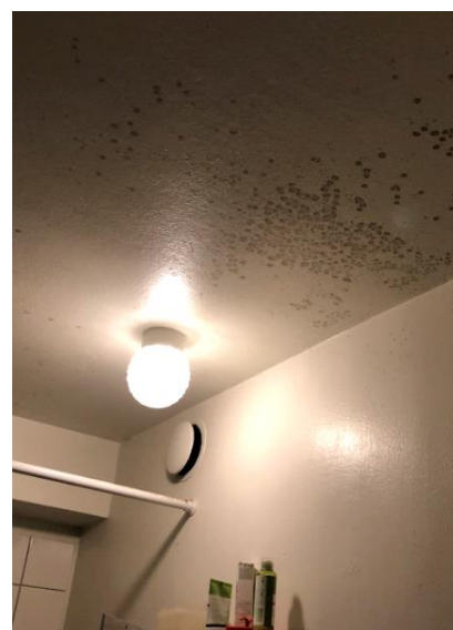
Skadat tak i badrum
