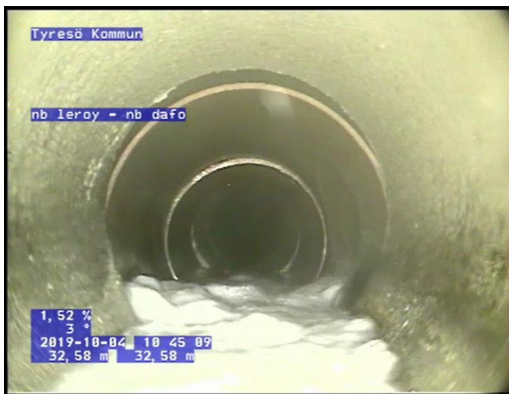
En upptäckt felkoppling från spilledningsnätet till dagvattennätet. Vitt skummande vatten tyder på processvatten som eventuellt hamnar i recipienten. Se åtgärd i tabell 2. Källa: Tyresö kommun
