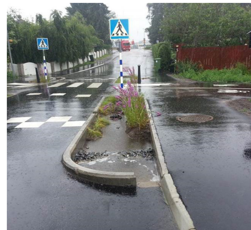
Bra exempel på välfungerade regnträdgård för lokalt omhändertagande av dagvatten i vägmiljö, Öringevägen i Tyresö.
