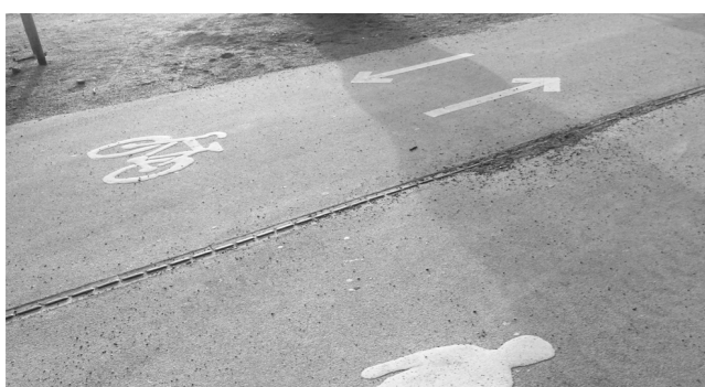
Exempel på cykel- och gångbana i asfalt som skiljs åt av avvikande material.
