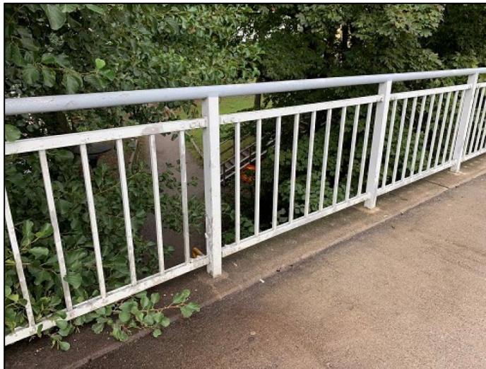
Figur 8, färgen på räcket har börjat flagna.
